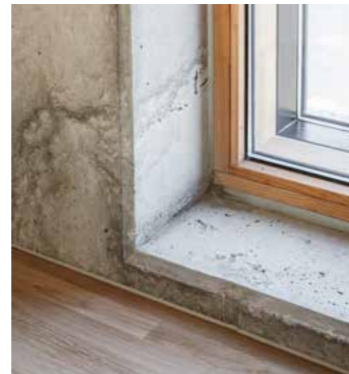
Détail des assemblages dans les maisons de Anders Lendager, les béton préfabriqués sont des éléments refusés pour le métro de Copenhague, leur défaut rend le matériau vivant comme du marbre © Rasmus Hjørtshøj
